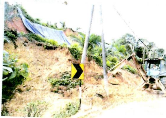
JKR melakukan kerja pembersihan di lokasi cerun runtuh dengan pemantauan berterusan.
